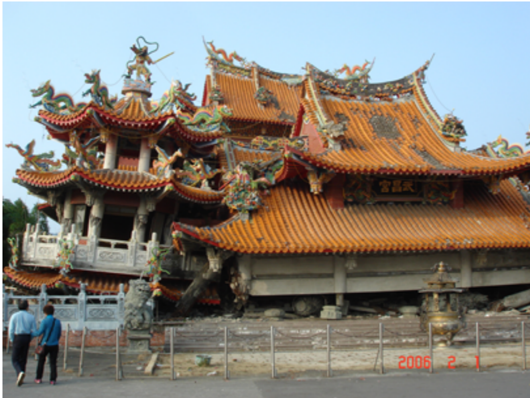
地震造成之建築物坍塌 (施堅仁 / 攝)
