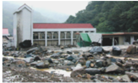
土石流強大衝擊力常造成下游房屋毀壞。 (資料來源：陳榮河，2010。坡地災害認知與防範。2010年臺北市災害防救深耕計畫-教育訓練課程。)
